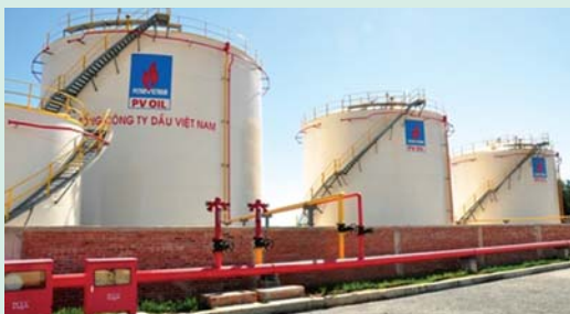
Khu bồn chứa và trạm xuất xăng dầu Quảng Ngãi tại Khu kinh tế Dung Quất. Ảnh: PTSC
